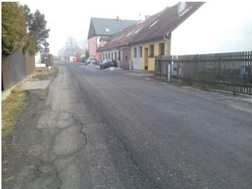
13. III/2525 Jirkov, ul. Palackého až III/2524
